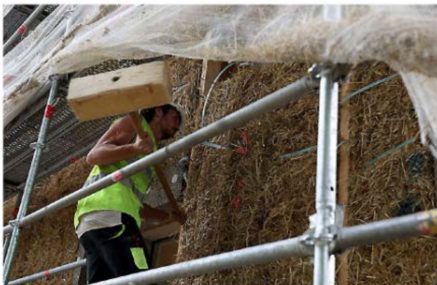
Les matériaux bio-géosourcés permettent de mieux isoler et, ainsi, de moins chauffer. MAURITZ - FARM VALÉRIE
