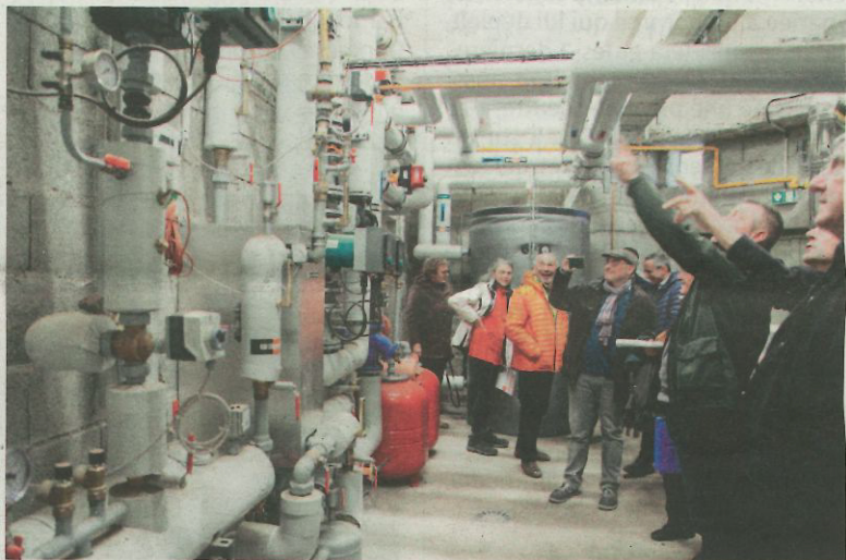
▲ Les nombreux éléments du réseau de chaleur déclenchent l'étonnement des élus. PHOTO DR
