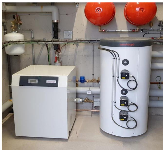
Intérieur de la chaufferie avec la pompe à chaleur et le ballon tampon
